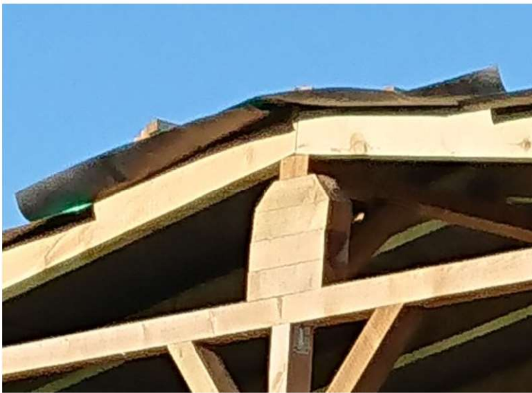
Fot.7.9 Detal więzara wykonany według fantazji wykonawcy. Praca i bezpieczeństwo takiego rozwiązania są co najmniej dyskusyjne. (fot. E.I. Kotwica)
