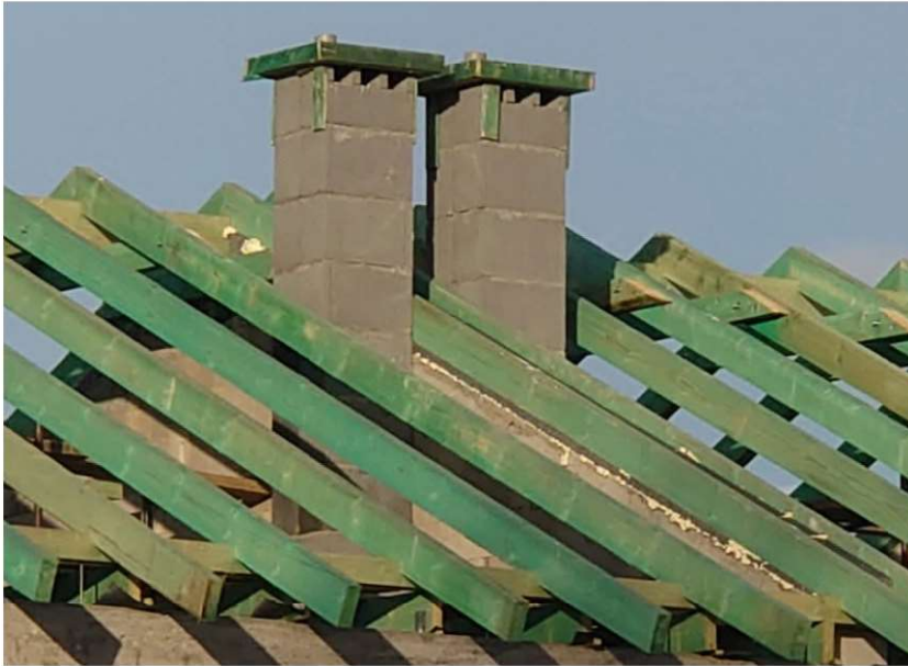
Fot. 2.2 Mniej lub bardziej intensywne zielone zabarwienie konstrukcji nie świadczy o poprawnej impregnacji (fot. E.I. Kotwica)
