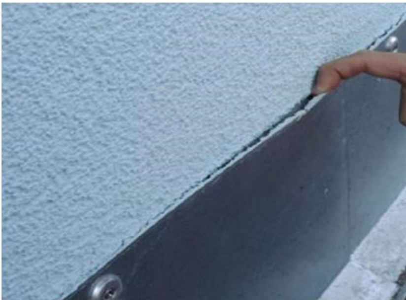
Fot.7.20 Niepoprawnie wykonana obróbka – z pominięciem systemowego profilu przejściowego. (fot. z archiwum Stowarzyszenia EDG)
