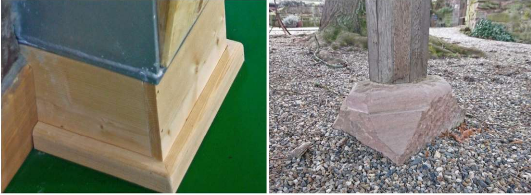
Fot. 7.29 TAK. Konstruując odpowiednio podporę można oddalić konstrukcyjny element drewniany od podłoża, zapobiegając tym samym jego zawilgoceniu. Po lewej stronie podstawę słupa odsunięto od podłoża, obudowując element fundamentu żelbetowego drewnem. Zdjęcie po prawej stronie pokazuje, że wiedzę tę posiadali już dawni mistrzowie budowlani (fot. E. I. Kotwica)
