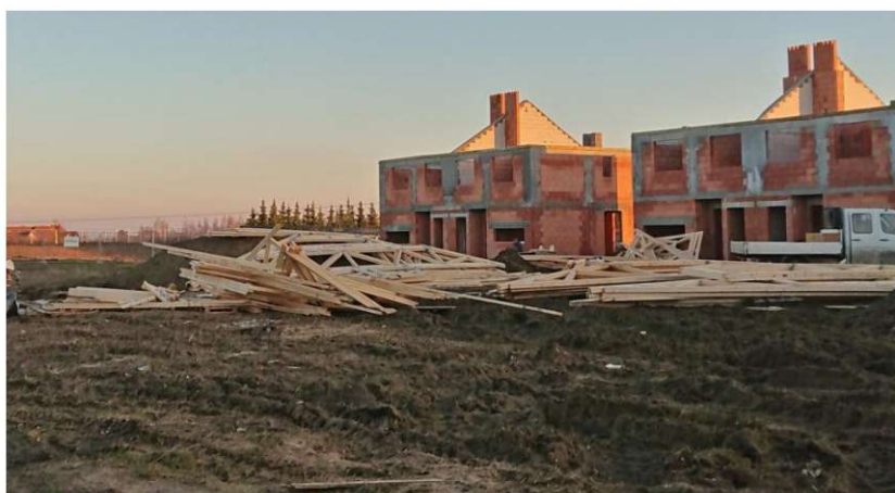
Fot. 7.8 Niepoprawny sposób składowania wiązarów kratowych i drewna – elementy konstrukcyjne leżą w sposób przypadkowy, w bezpośrednim kontakcie z gruntem. (fot. E.I. Kotwica)
