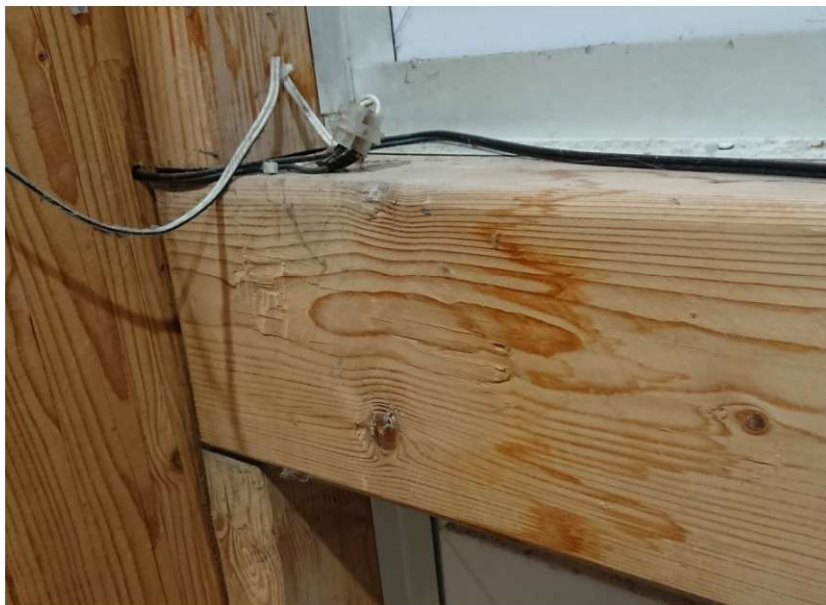
Fot.7.21. Nieszczelność obudowy powoduje zawilgocenie drewnianych elementów konstrukcyjnych i docelowo ich korozję biologiczną (fot. E. I. Kotwica)
