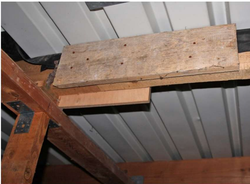
Fot. 7.14 Przypadkowe i niestaranne wykonanie połączenia styku. (fot. E. I. Kotwica)
