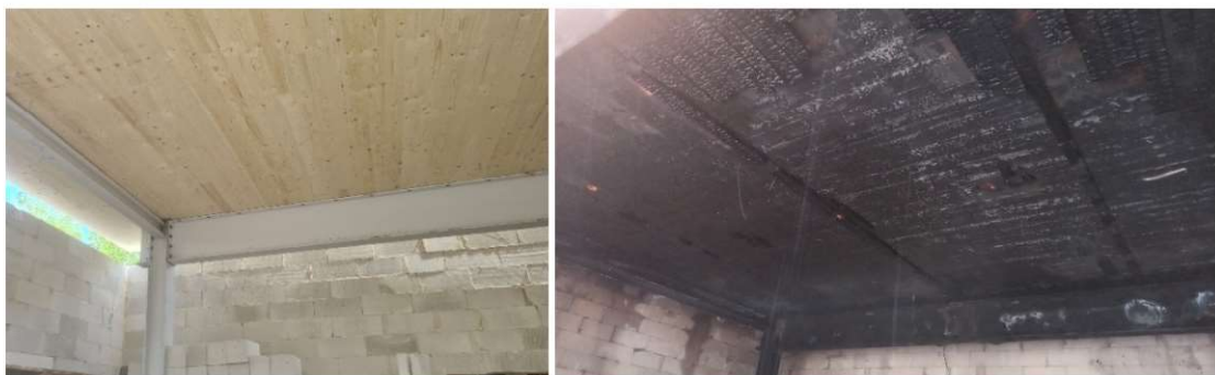
Fot. 6.11. Widok obciążonego stropu z drewna klejonego przed i po ponad 2 godzinnym w pełni rozwiniętym pożarze (fot. P. Sulik)
