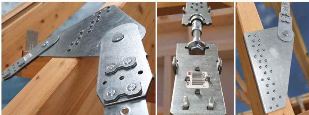
Fot. 7.23 TAK. Poprawnie wykonane detale stężeń systemowych z zastosowaniem taśmy perforowanej. Zastosowanie pokazanej na środkowym zdjęciu nakrętki napinającej pozwala na właściwe napięcie stężenia w przypadku zastosowania taśmy. (fot. T. Szczesiak)
