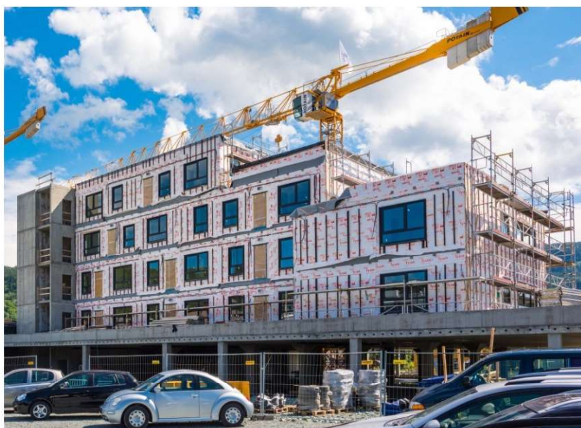
Fot.5.13 Montaż modułowego budynku wielorodzinnego przez polskiego producenta w Norwegii (fot. z archiwum Stowarzyszenia Energooszczędne Domy Gotowe)
