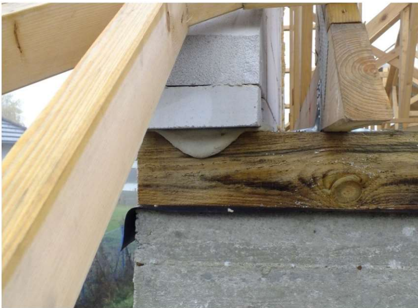
Fot. 7.16 Nieprawidłowe łączenie konstrukcji drewnianej oraz konstrukcji wykonanej w technologii mokrej. Jakość podwaliny pozostaje bez komentarza (fot. E. Kłosowski)
