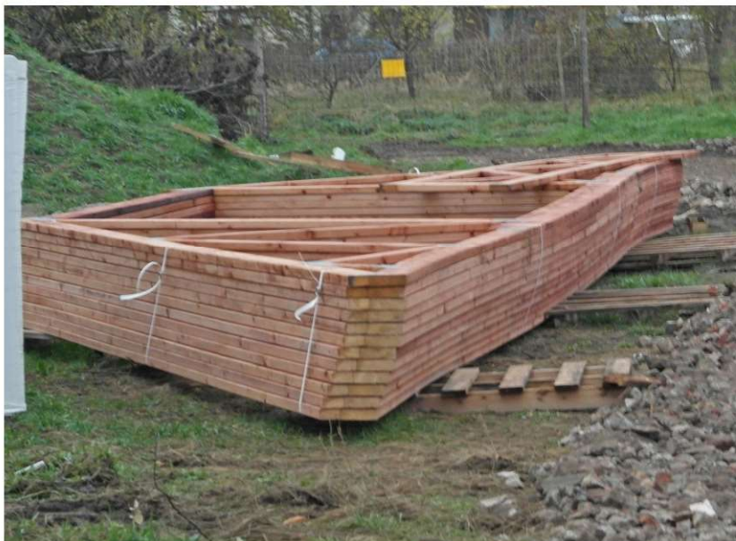
Fot. 7.7 Niepoprawny sposób składowania wiązarów kratowych – widoczne odkształcenia spowodowane nierównością podparć oraz zbyt bliska odległość od ziemi. (fot. E.I. Kotwica)
