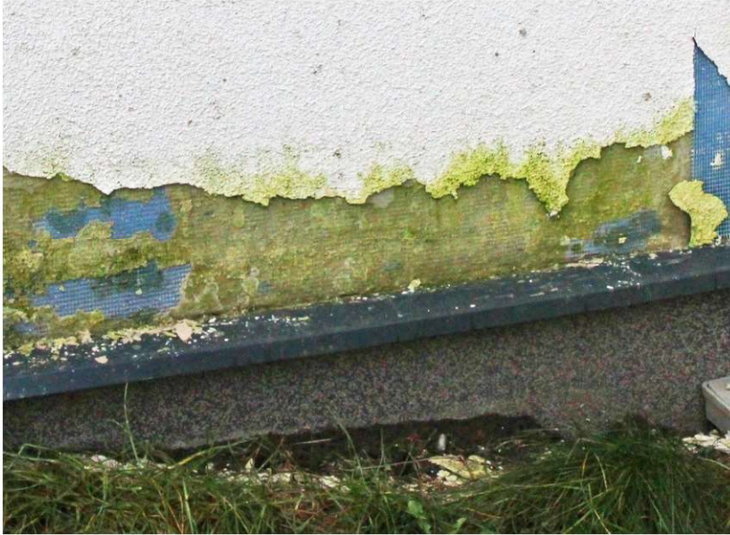
Fot.7.19 Niepoprawnie zaprojektowany i wykonany detal połączenia ściany budynku ze ścianą fundamentową – wykonanie cokołu wystającego poza lico ściany skutkuje zaleganiem wody i korozją w obrębie ściany, cokół jest też za niski (fot. E.I. Kotwica)
