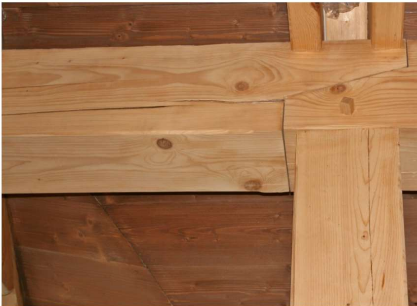
Fot. 7.12 Zastosowanie drewna nie-przeznaczonego do celów konstrukcyjnych w połączeniu z przyjętym rozwiązaniem (nie wiadomo, czy przez projektanta, czy „pomysłowego” wykonawcę) skutkowało spękaniem i brakiem pracy części odspojonej. Niezbędne wzmocnienie. (fot. E. I. Kotwica)
