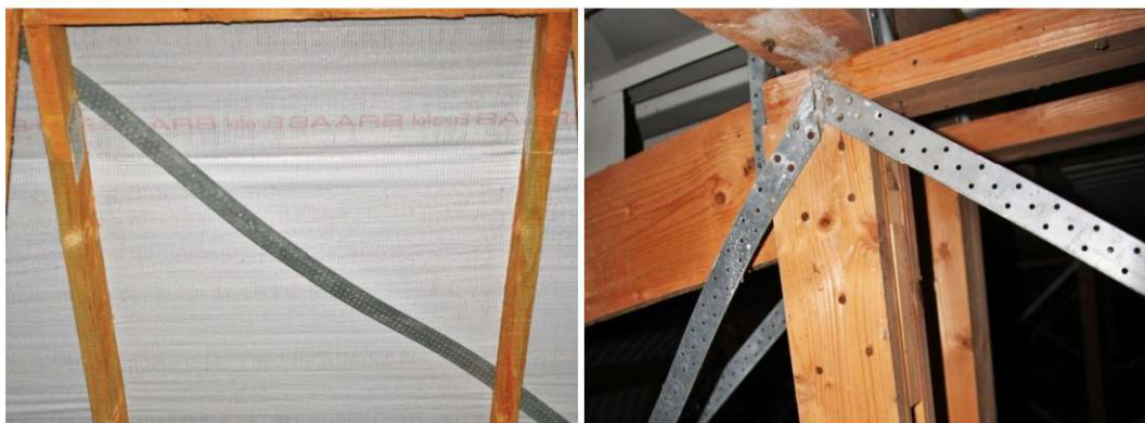
Fot. 7.22 NIE. Przypadkowe wykonanie stężeń z zastosowaniem taśmy perforowanej. Po lewej stronie wyraźne obwiśnięcie taśmy, co powoduje, że nie spełnia żadnej roli jako stężenie, po prawej stronie przypadkowe, niczego nie gwarantujące zamocowanie taśmy na elemencie drewnianym (fot. E. I. Kotwica)
