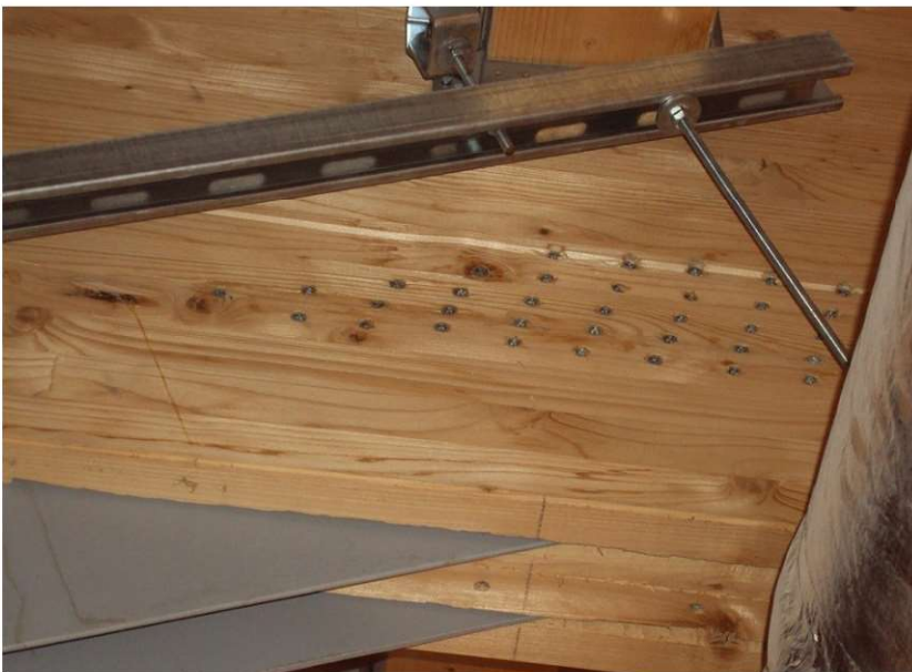
Fot. 4.9 Błędne mocowanie ściągu skutkujące spękaniami w osi ostatnich łączników (fot. R. Orłowicz)
