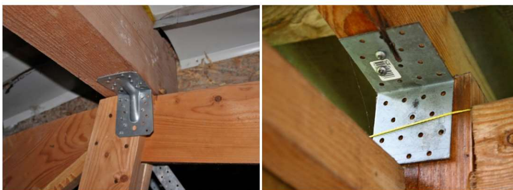
Fot. 7.24 NIE. Niepoprawne, przypadkowe zamocowanie kątowników. Po lewej stronie zastosowano losowo dobraną i rozmieszczoną liczbę łączników, dodatkowo niepoprawnie sytuując kątownik. Po prawej stronie połączenie wygląda tak, jakby właśnie wykonawcy skończyły się gwoździe i wkręty. (fot. E. I. Kotwica)
