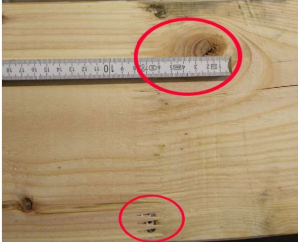
Fot. 2.5 Odległości sęków od złącza klinowego w elemencie pokazanym na zdjęciu są niezgodne z normą EN 15497 [N27] (jeden sęk bardzo blisko złącza, jeden sęk w złączu). Elementy z takimi sękami należy odrzucać z dostawy, żądając ich wymiany i nie wolno ich wbudowywać. (fot. E. I. Kotwica)
