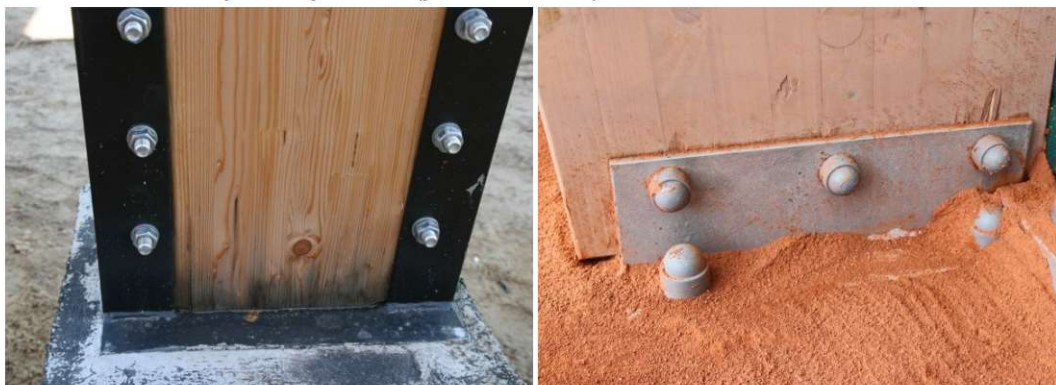
Fot. 7.28 NIE. Niepoprawne wykonstruowanie i wykonanie podpór słupów. Usytuowanie drewna w bezpośrednim sąsiedztwie wilgotnego podłoża skutkuje podciąganiem kapilarnym wody, a docelowo – korozją biologiczną (fot. E. I. Kotwica)
