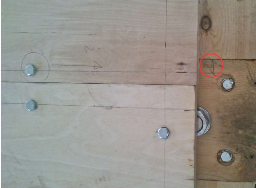
Fot. 7.15 Brak zachowania normowych odległości od krawędzi łączonego materiału. Na czerwono zaznaczono odległość osi łącznika od krawędzi elementu drewnianego – mniejszą niż wymagana normowo (fot. E. I. Kotwica)
